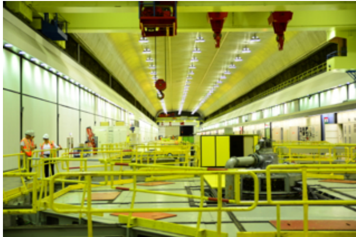
Generatorenhalle 300 Meter unter dem Boden
